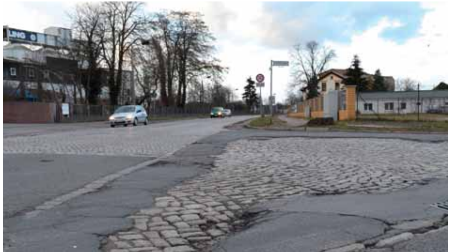
Holperpflaster adé: Der Ausbau des letzten Teilstücks der L 172 beginnt in wenigen Wochen.
